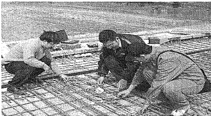
图 7-8 光纤光栅传感器在桥面板上的布设照片
